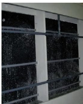
Erste Stufe Abluftwäsche
